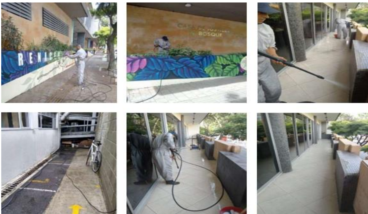
CASA DE JUSTICIA EL BOSQUE: Hidrolavado en zonas internas y externas de la sede.
