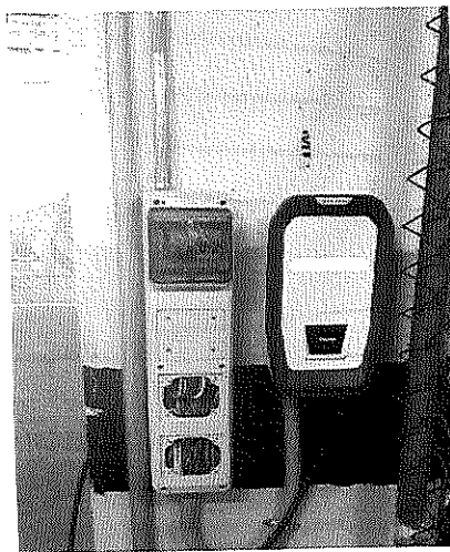
WALL BOX (CANTIDAD: 3 INSTALADO)
